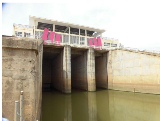
写真-4 築わずか5年程度の頭首工
