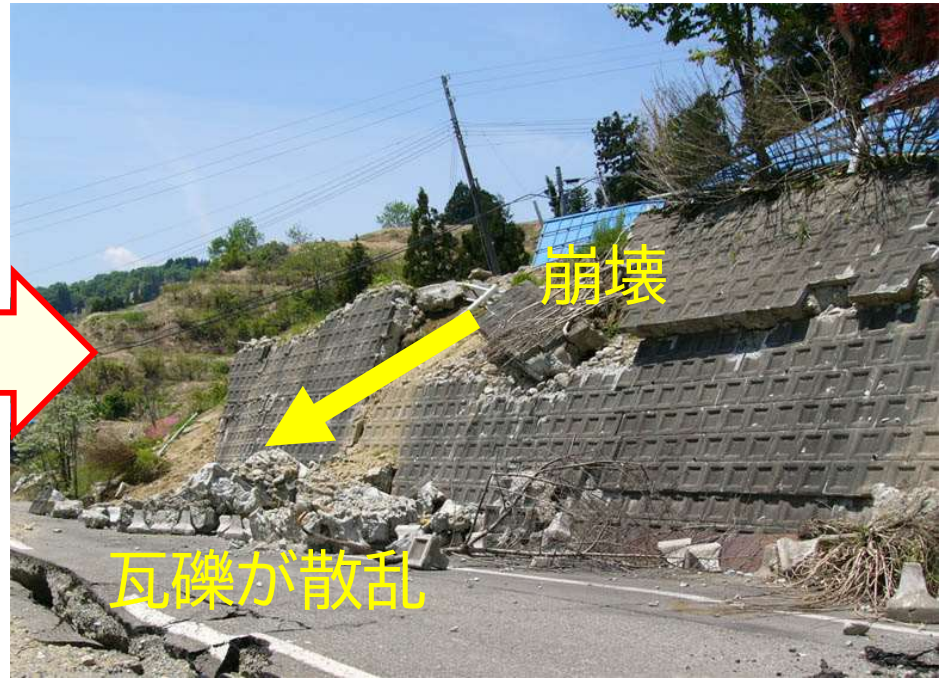
擁壁が崩壊し道路閉塞した事例 (新潟県旧山古志村 国道291号線)
