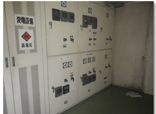
受変電設備の老朽化
