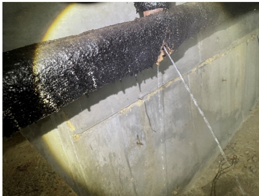
給水管漏水 （腐食発生）
