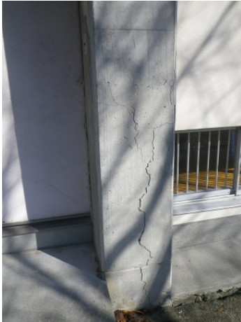
鉄筋コンクリート柱のひび割れ
