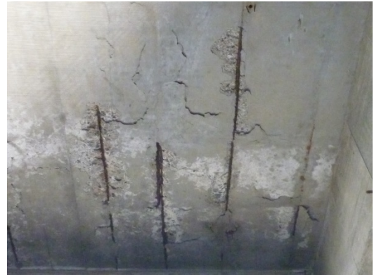
鉄筋コンクリート床下の鉄筋腐食
