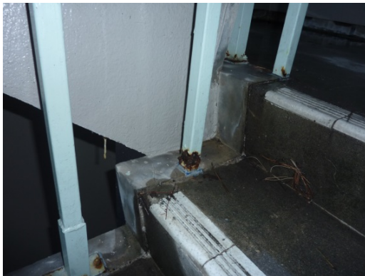
階段手すり鋼材の腐食
