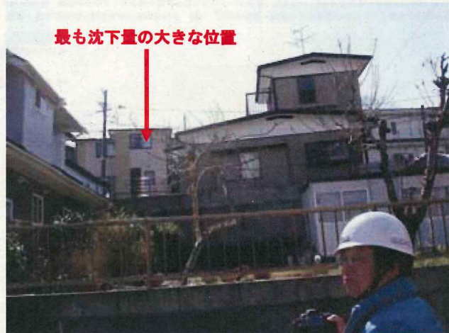
最も沈下量の大きな位置に向かって左右の家屋が傾斜していることがわかる。
