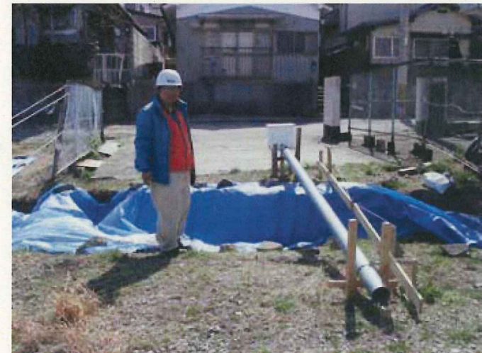
南側盛土上部の滑落崖
